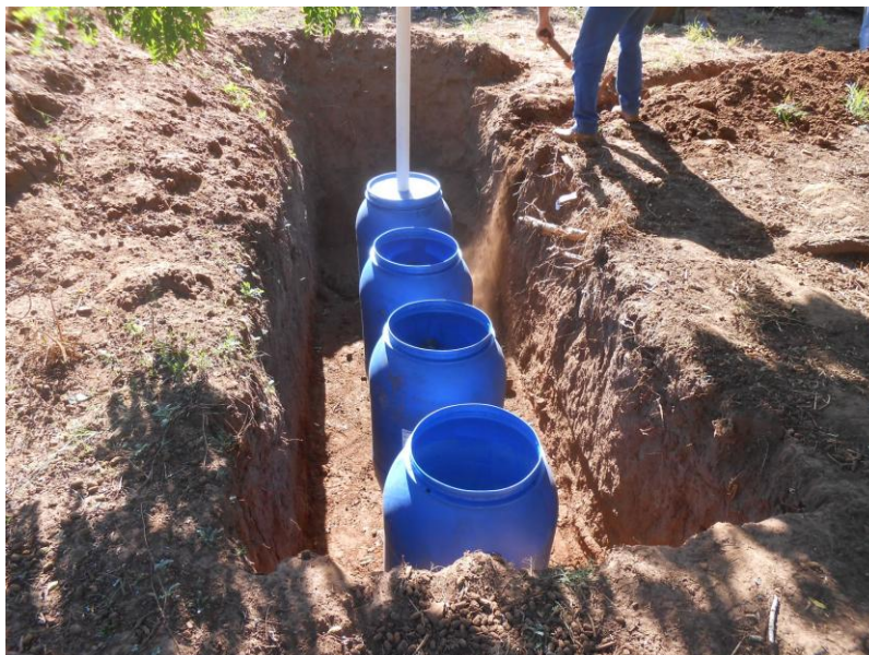
Figura 08: Fossas com filtros biológicos
